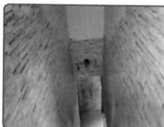
Anomalie B.3.3.6 a3 sur Install. n°1
