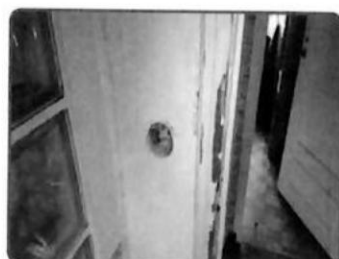
Anomalie B.7.3 a sur Install. n°1
